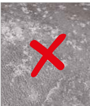
Enkelvoudige uitvoering: corrosie
