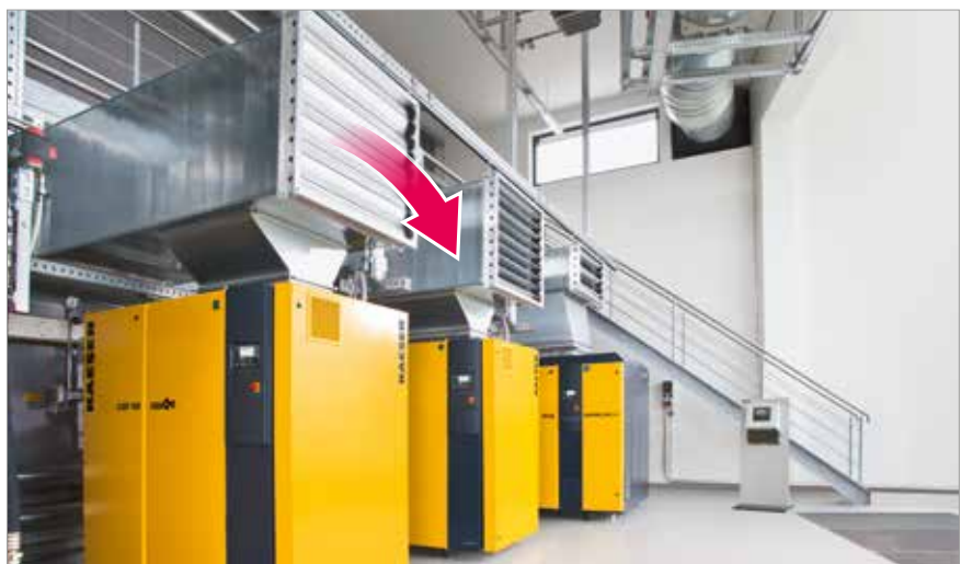
Afb. 3: Persluchtstation met thermostatisch gestuurde luchtgeleiding
