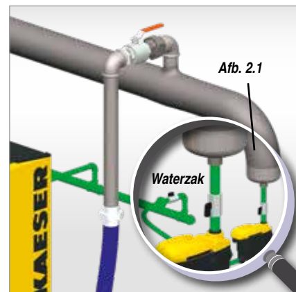
Afb. 2: Leiding met waterzak en condensaat­aftappunt
