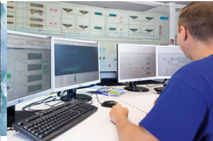
Tous les process sont surveillés et commandés par des personnels qualifiés à l'aide de systèmes de contrôle-commande très modernes.
